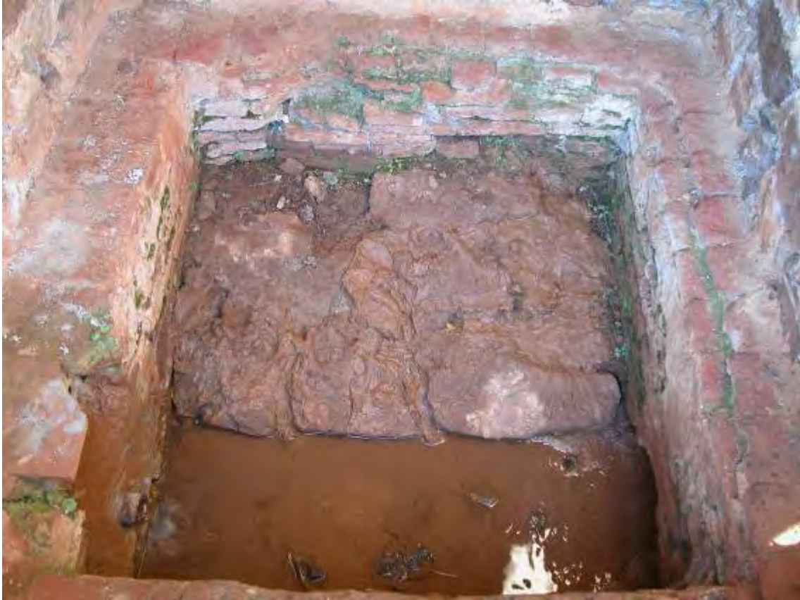
Fig. 17. Pavimento de la alcubilla. El agua entra por el caño ubicado a la izquierda de la imagen, saliendo por un desagüe localizado a la derecha de la misma. En la base del muro oeste (al frente de la foto) existe una antigua acometida de agua que fue tapiada con ladrillo
