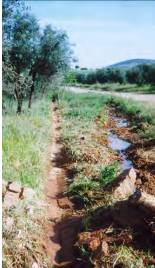
Fig. 18. Acequia de ladrillos que comunica alcubilla y alberca, en precario estado de conservación. El agua discurre fuera de la acequia e inunda de forma ocasional el camino
